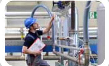
Inbetriebnahme der Anlage
